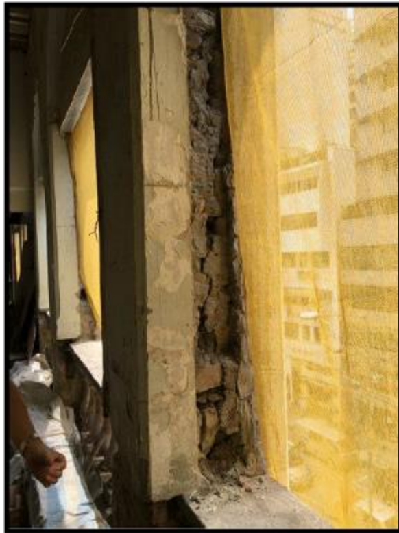
圖 6b: 已婚督察宿舍大樓東翼其中一條磚柱在移除批盪後發現的垂直裂縫
